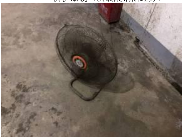
排风扇（污泥脱水车间）
