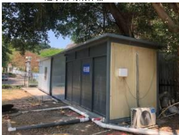
站内污水进、出口在线监测设备房
