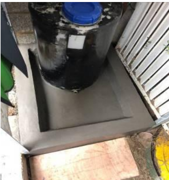
次氯酸钠储罐围堰
