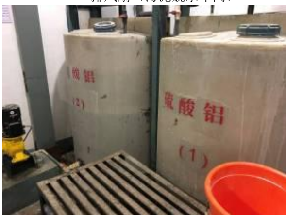
加药间硫酸铝储罐
