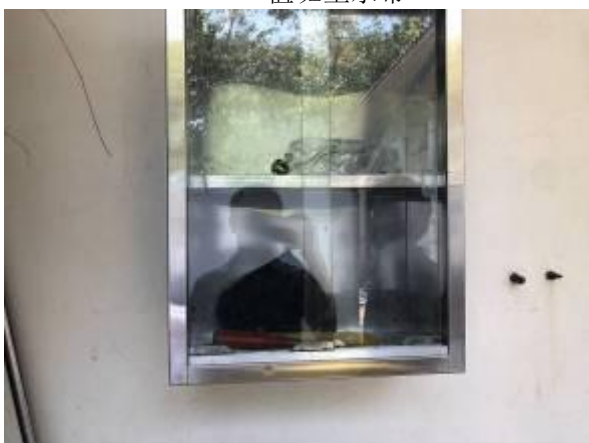
防护眼镜（次氯酸钠储罐旁）
