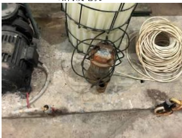
移动式应急水泵（加药间）
