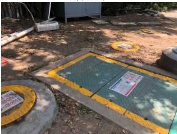
污水处理水池地面检查井
