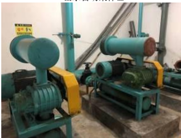
风机房备用风机
