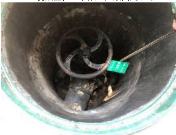
污水排放口阀门
