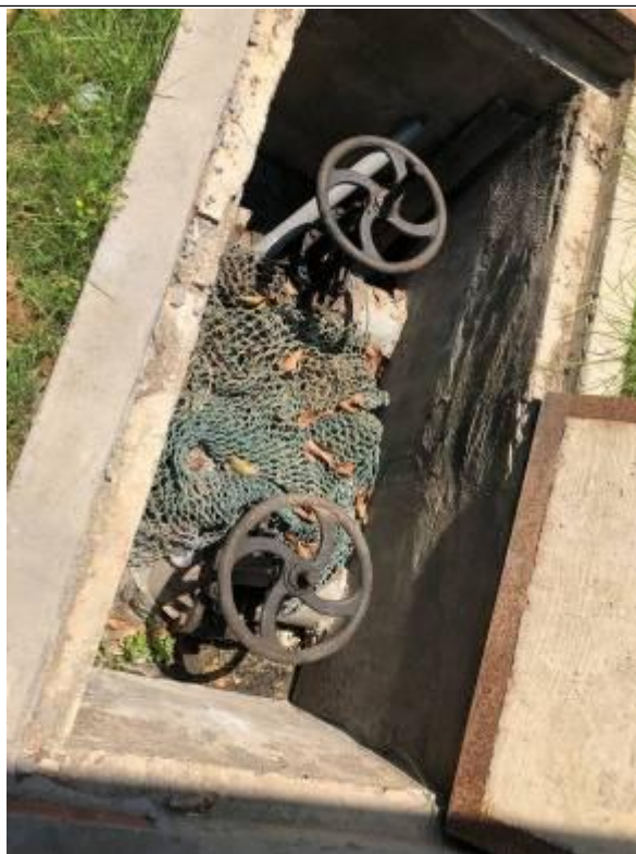
污水处理构筑水池连接阀门
